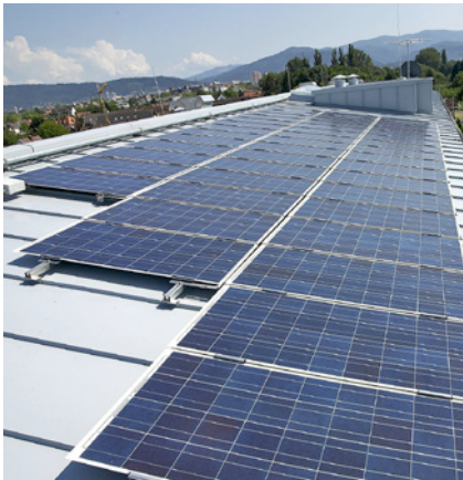
Photovoltaik-Anlage auf dem Clarion Hotel Hirschen in Freiburg
