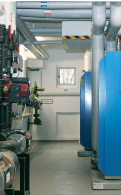
Neue Heizungsanlage, durch Contracting finanziert
