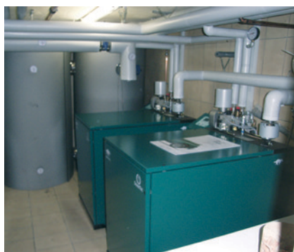
Blockheizkraftwerk aus 3 Modulen mit Pufferspeichern
