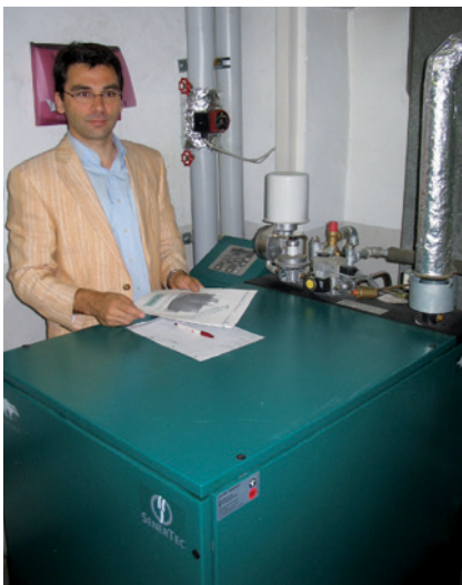
Abbildung: Blockheizkraftwerk im Hotel Kastanienhof.
